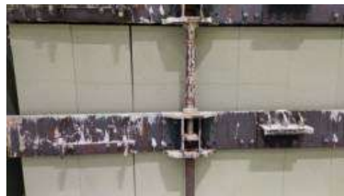
Фото 4. Трещины газобетонных блоков, появляющиеся в результате неправильной работы кантователя
