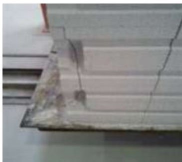
Фото 3. Механические повреждения массива при резке
