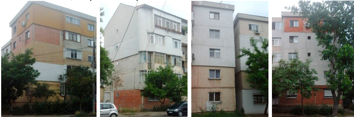
Рисунок 1. Неэффективная система утепления наружных стен.
