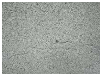
Фото 2. Усадочные трещины в теле ячеистого бетона
