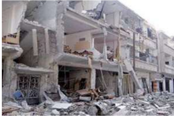
Рисунок 1. Характер разрушения железобетонных конструкций зданий
