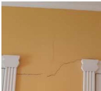
Фото 6. Трещины в газобетонных стенах, возникшие в процессе эксплуатации
