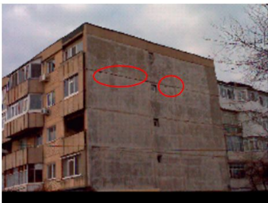
Рисунок 9. Дegradaция поверхности неизолированного здания.
